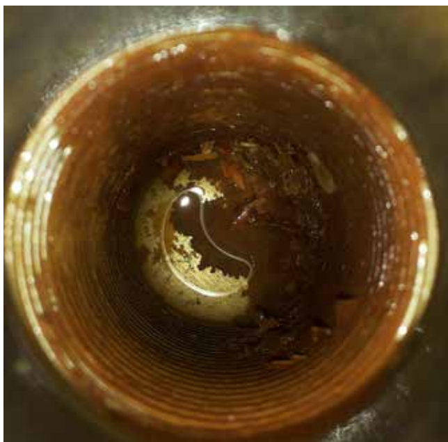
Vnitřek teplovodní soustavy před a po vyčištění
