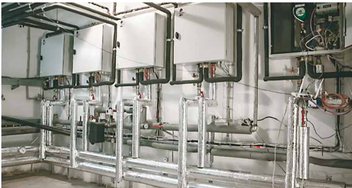
Obr. Lokální výtopna – kaskáda tepelných čerpadel o celkovém výkonu 140 kW
