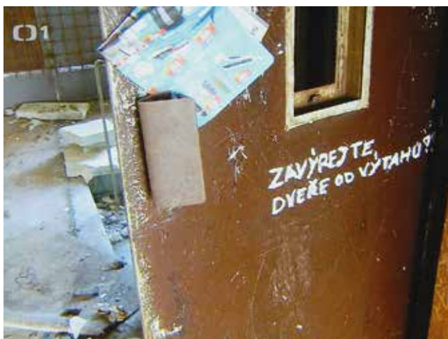
Výtahové šachty byly zaplněné až do úrovně čtvrtého patra – rozbitými okny, kusy nábytku, injekčními stříkačkami apod.
