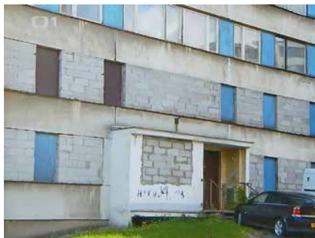
V 90. letech město prodalo bytové domy při privatizaci. Noví vlastníci do nich začali stěhovat problémové lidi. Dům „vybydleti“. Zazdít vše do prvního patra – jediná možnost jak zabránit dalším problémům.
